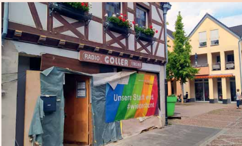
„Unsere Stadt wird wieder bunt“ verspricht die Aufschrift an diesem beschädigten Haus in Ahrweiler.
