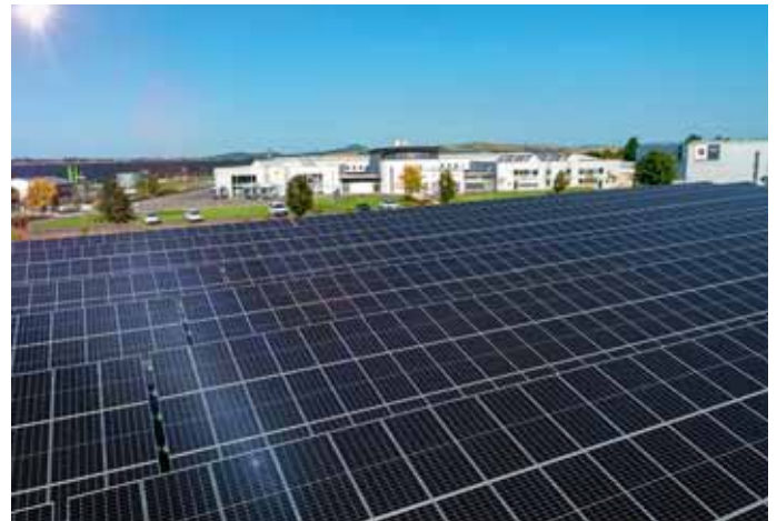
Auf dem Werksareal in Polch installierte Niesmann + Bischoff mehr als 9000 Solarmodule, mit denen ein großer Teil des Energiebedarfs gedeckt werden kann.
