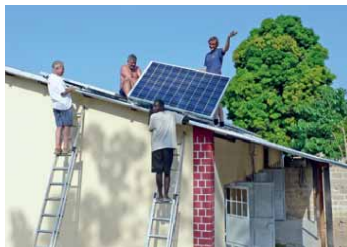
Mit der Unterstützung von Remis konnte die Solaranlage einer Krankenstation in Gambia ausgebaut werden.
