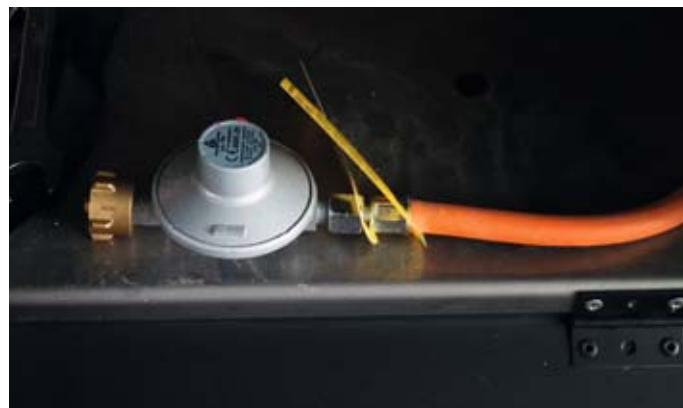
Hat ausgedient: Der alte einfache Gasdruckregler musste einer DuoControl weichen.
