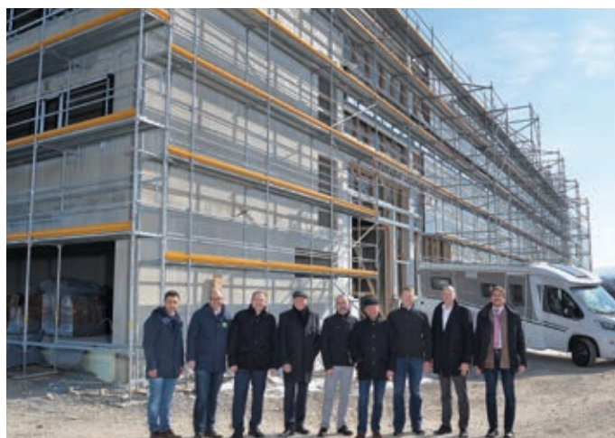
Die Verantwortlichen bei Dethleffs freuen sich über die Fertigstellung des Rohbaus der neuen Werkhalle in Isny. 180 neue Arbeitsplätze sollen hier entstehen.
