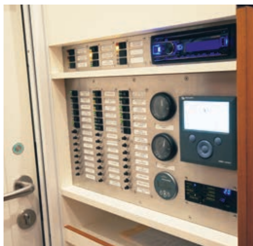
Die Technikzentrale im neuen Unicat lässt keine Wünsche offen.
