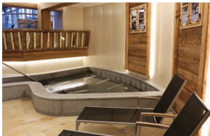
Auf dem Holmernhof in Bad Griesbach steht den Gästen nun eine Whirlpoolanlage zur Verfügung.
